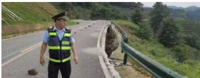
现场挡墙垮塌图
